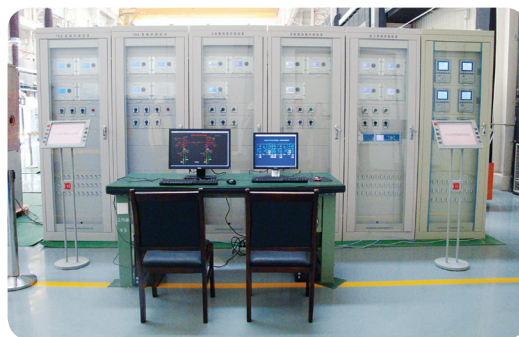
铁路牵引变电站综合自动化系统
