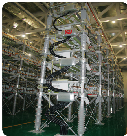
世界首个多端柔性直流输电工程—南澳岛多端柔性直流示范工程青澳换流站换流阀
