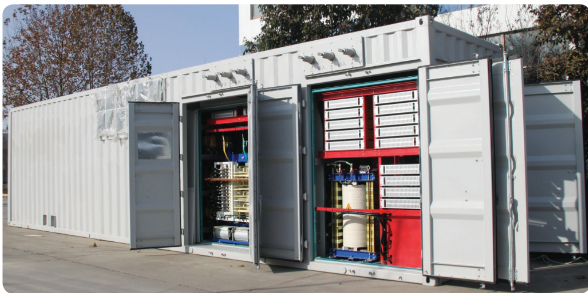
面向新能源发电的超导储能-限流装置
