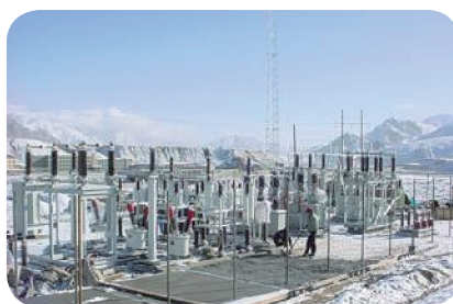
参与建设的青藏线 35kV 电力贯通线路工程串联补偿工程，确保电源稀缺条件下的青藏铁路供电质量和系统稳定运行
