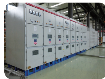
研制的铁道电气化同相供电装置，可提高供电质量和效率，降低电能消耗，满足我国铁路重载货运、快速客运发展的迫切需要
