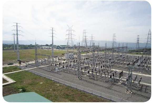
2014 年，承建的菲律宾 Kirahon 变电站正式送电投入使用
