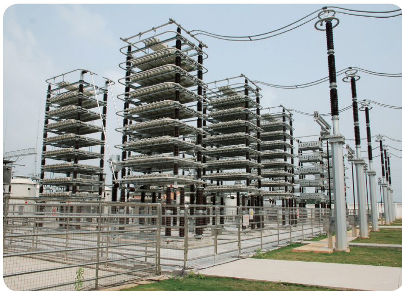
运行在 \pm 800\text{kV} “云—广” 特高压直流输电工程穗东换流站的滤波电容器装置
