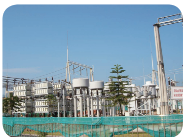
参与建设的峨嵋钢铁集团供电系统 SVC 工程，可改善供电品质，提高功率因数，减少电力损失，提升电能使用效率，延长电力设备寿命，并可减少无功冲击和谐波对电网的影响
