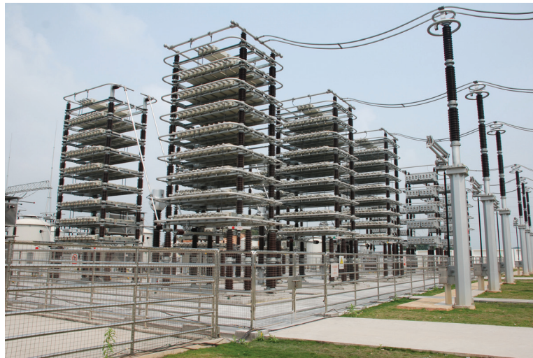
运行在±800kV“云—广”特高压直流输电工程穗东换流站的滤波电容器装置
