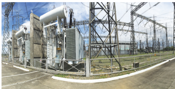
菲 San Jose 500kV 变电站
