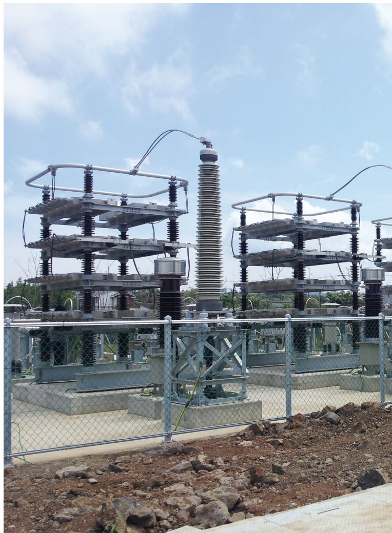
韩国济州 ±80kV 60MW 直流输电示范工程 交流场
