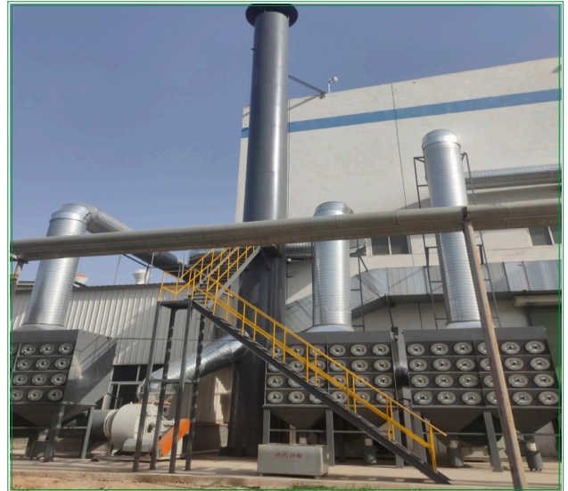
西电常变、西电济变升级喷涂线废气治理设施
